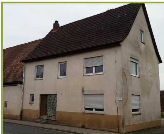
Marodes Gebäude Hauptstraße
